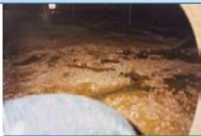
残油スラッジ抜取
