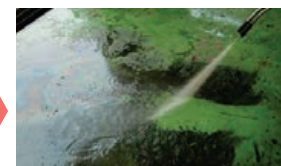
高圧ジェット洗浄
